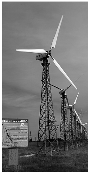
Мал. 81. Мирнівська вітрова електростанція
